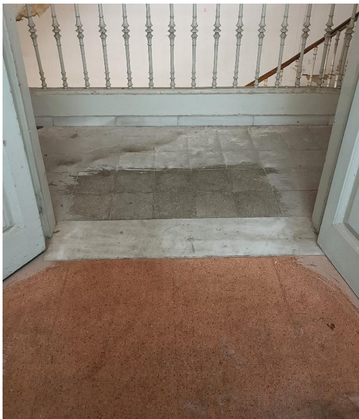
Paviment de terratzo de gra fi "rojo Alicante" 40x40cm
