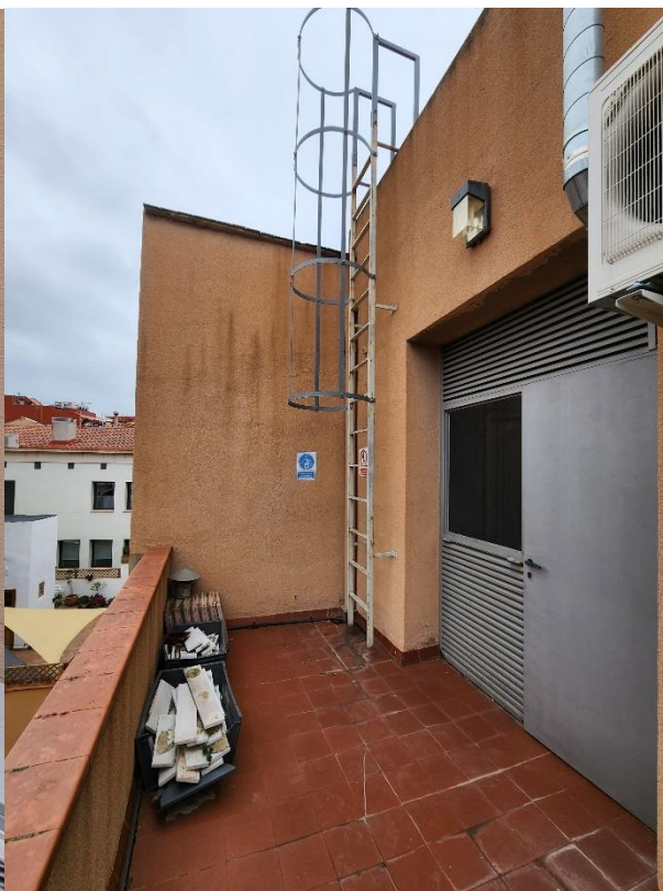
21. Terrassa Sala calderes
