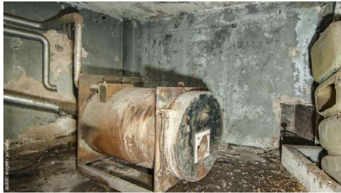
Fig. 44: Caldera de calefacció.
