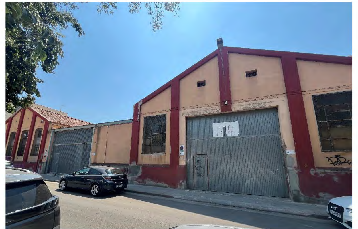
2025. Visió de la façana testera de la segona nau encarada al carrer de Pau Claris on es pot observar la permanència de l'important alteració que suposà l'obertura del gran portal d'accés frontal i que comportà l'alteració de la pilastra central, la fragmentació del sòcol i la pèrdua de dues obertures. Autor: Antoni Vilanova (V+M)
