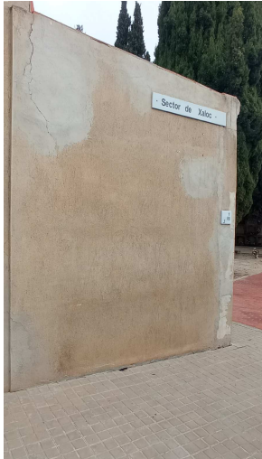
DETALL D'ESQUERDES EN EL MUR DE MITGERA
