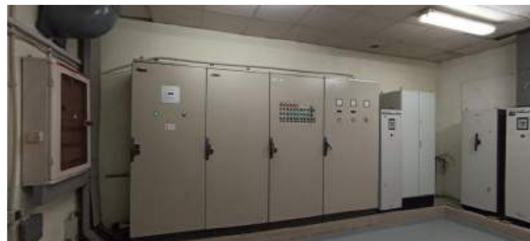
Figura 9: Quadre general de distribució (CGD) de la instal·lació
