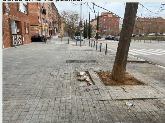
C. de Malta, paviment de la vorera deteriorat
