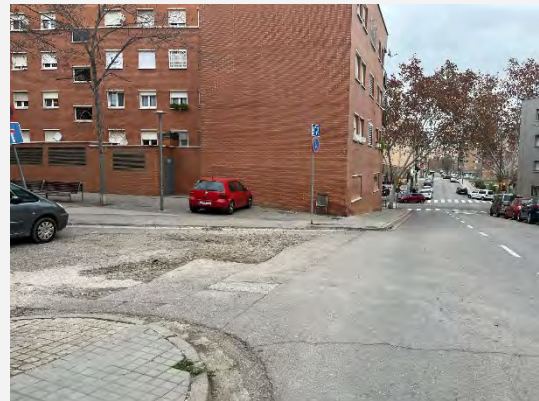
Manca de pas de vianants i paviment de la calçada deteriorat, c. Tenerife
