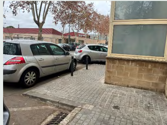
Vorera desplaçada que pot dificultar l'itinerari de persones PMR, c. de la Palma.
